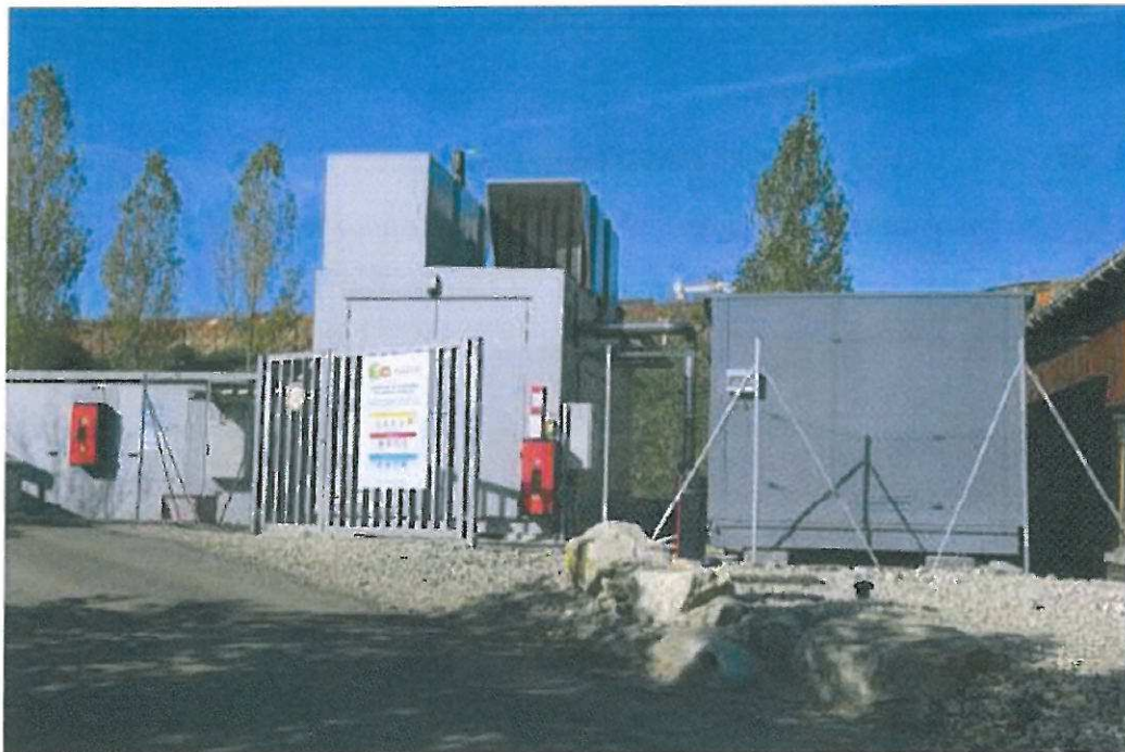
Figure 3 : Plateforme de valorisation du biogaz
